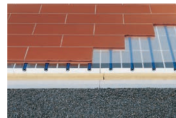
Estrichziegel auf Fußbodenheizung. Trittschalldämmung aus Holzweichfaser (z.B. PAVATEX „PAVAPOR 22/21 oder 17/16“), Hartschaumdämmung EPS und TONALITY-Trockenschüttung.
